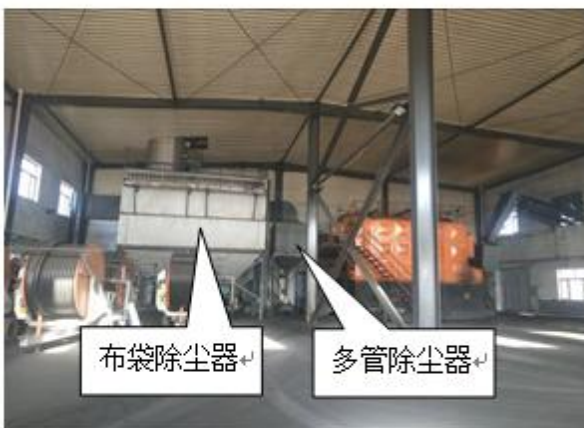
多管除尘器+布袋除尘器
